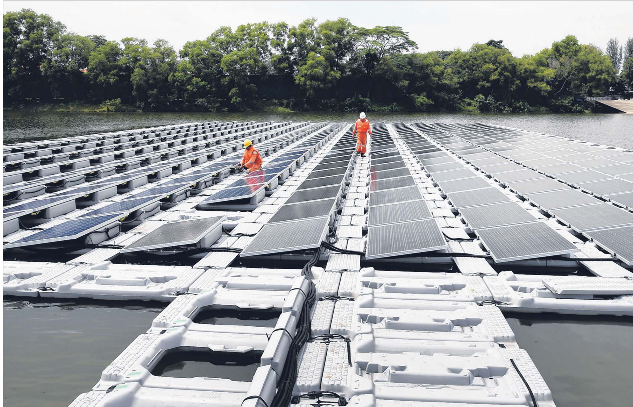
设于登格蓄水池、相信是全球最大的浮动太阳能板试验平台占地一公顷，全面启动后可生产一兆峰值电力。图为工作人员在检查太阳能板。（海峡时报）
